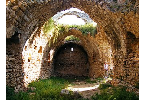
Das innere Gewölbe des Kızıl Han mit eingestürzten Deckenteilen
